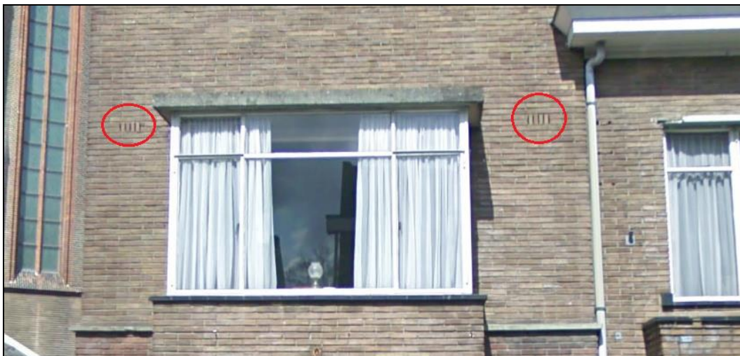
Figuur 4.4.1: Aanwezige open stootvoegen (rood omcirkeld) in de gevel van één van de panden in het plangebied.
