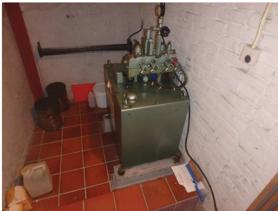
Foto 09: Hydraulische lift – Niet asbestverdacht
