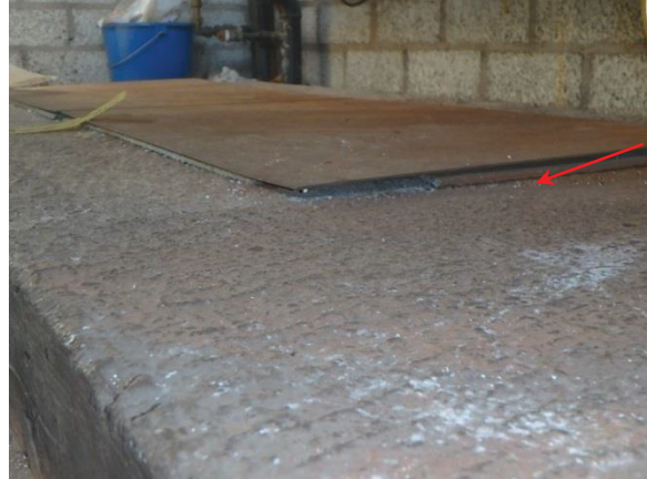
Foto 02: CV ruimte, op de opstort, onder metalen platen M01 plaatmateriaal - Asbesthoudend
