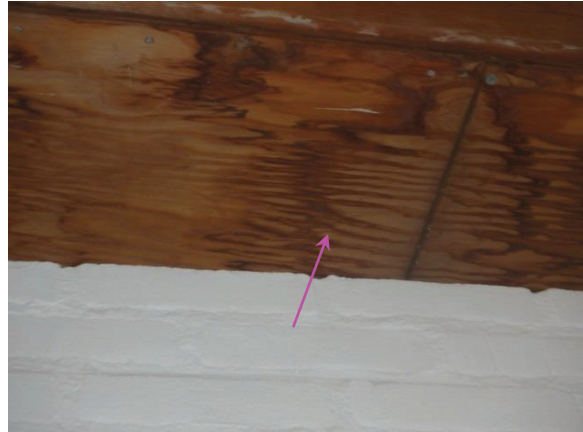
Foto 04: achter houten aftimmering van balken - Uitsluiting
