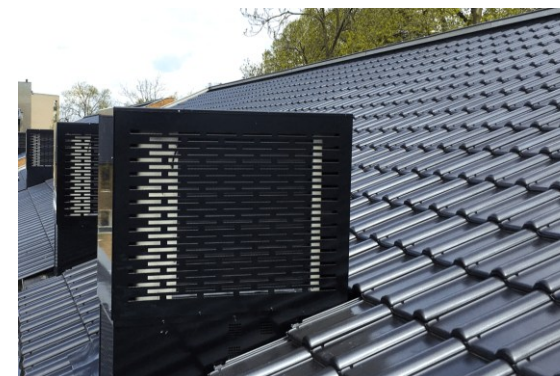
Buitenunit warmtepomp op hellend dak
