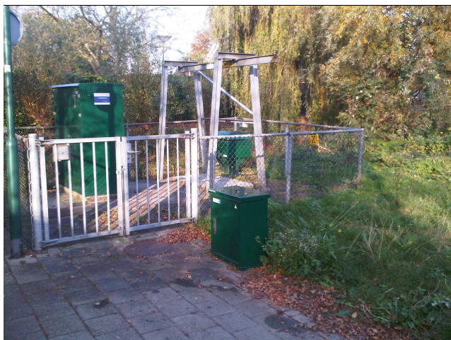
Figuur 3.2 Rioolgemaal van Waternet in noordwesthoek van plangebied blijft op de bestaande locatie
