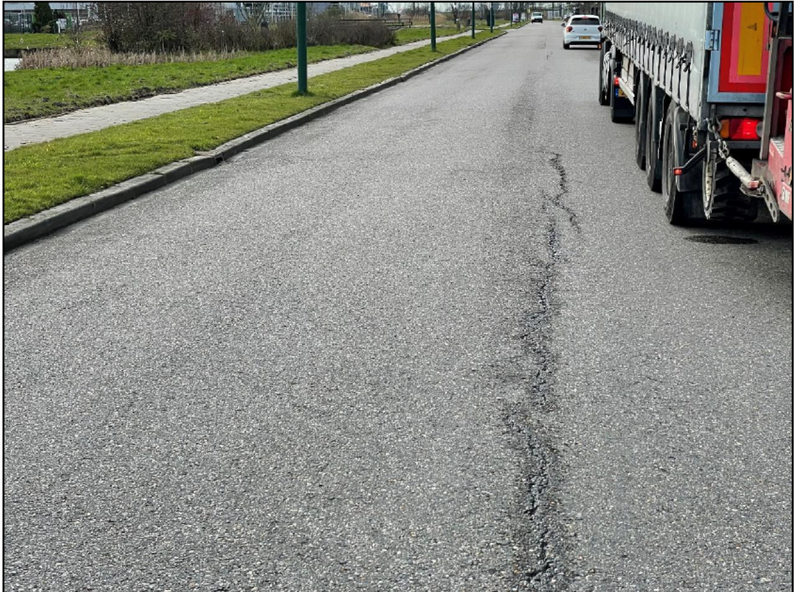
Figuur 3 Geconstateerde matige scheurvorming in vak 2
